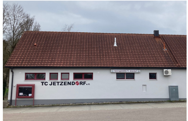
Streichen von Wänden und Holzteilen außen mit neuer Sockelfarbe und Logo-Anbringung an der Nordseite
